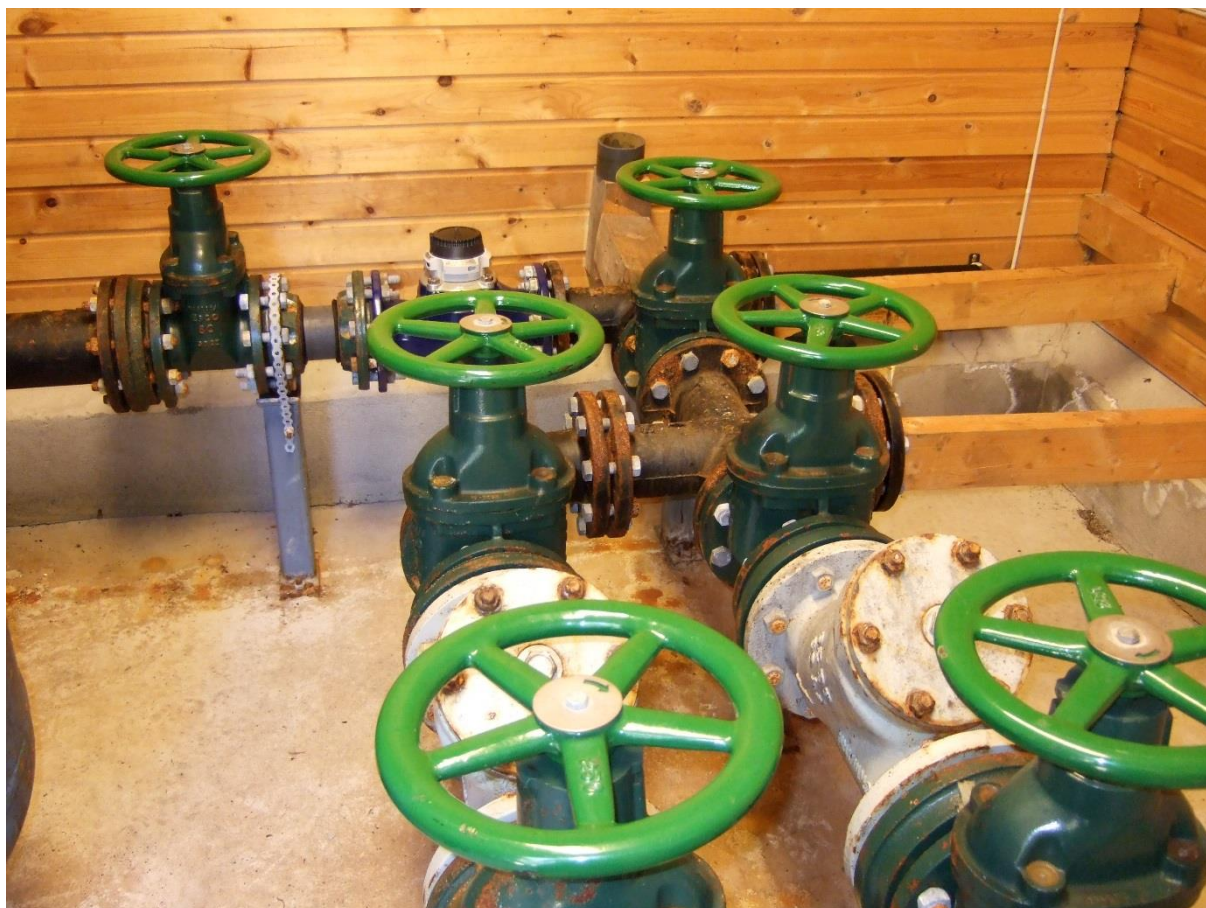
Figur 7 Bilde fra vannbehandlingsanlegg Kobbelveid Vannverk
